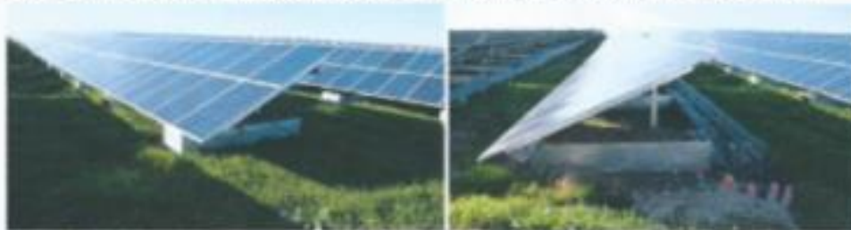
Photo 43 : Vues sur des longrines en gabion (source : QUADRAN, CET Saint-Jean-de-Liban, Hérault)
